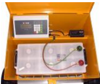
Batteriewagen mit Steuerung und ROYER Meldesystem SC 6
